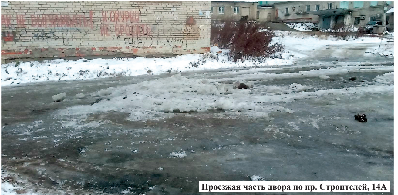
Канализационный люк, течь по пр. Строителей
