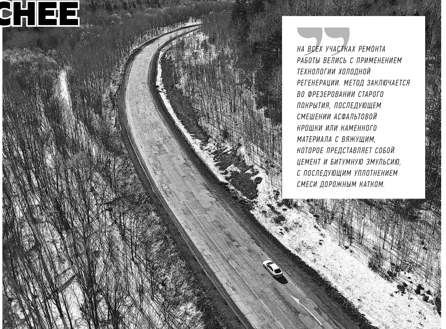
Покрытие дороги до ремонта
