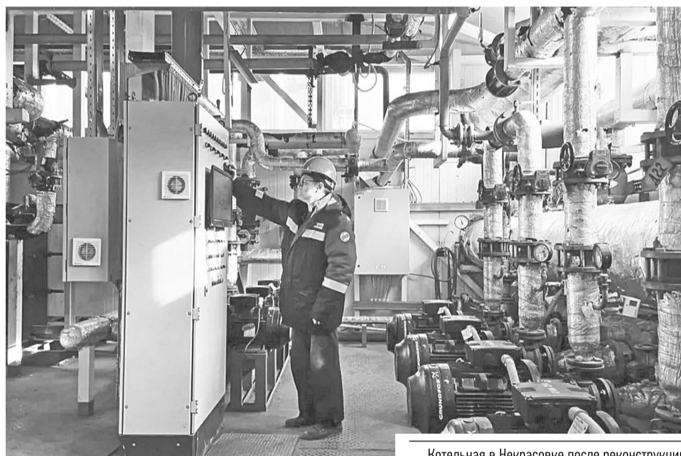
Котельная в Некрасовке после реконструкции
