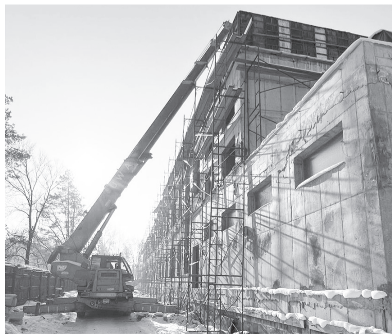
Подъёмным краном на строительстве пристройки к школе №1 управляет наш земляк Сергей Козлов.
