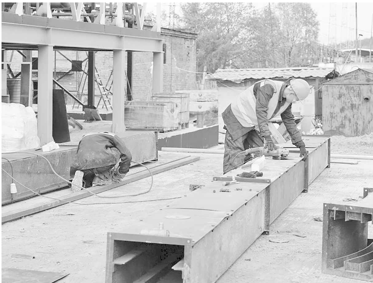
Новый объект будет иметь три водогрейных котла, работающих на угле
