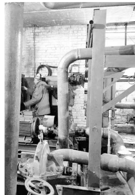
Котельная в п. Высокогорном
