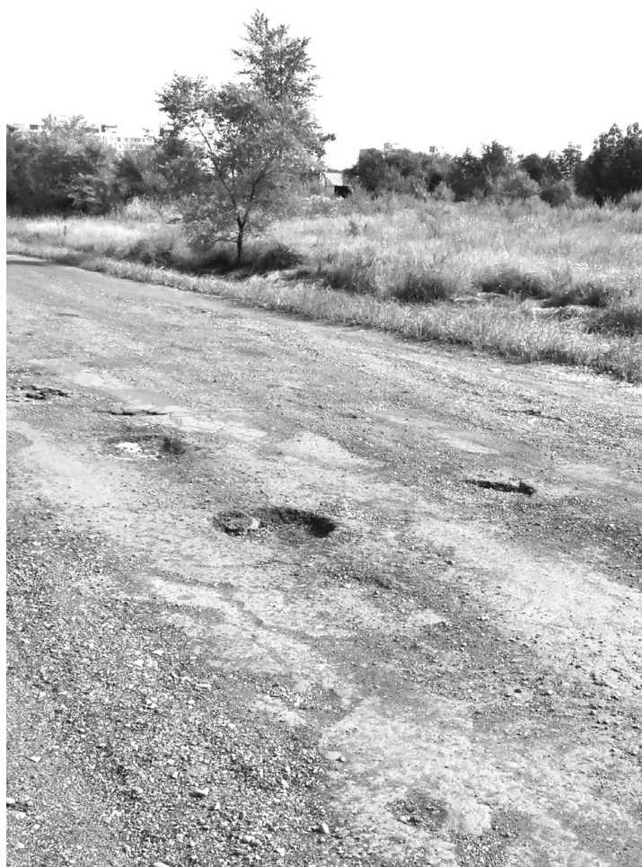
Проезд находится в плачевном состоянии
