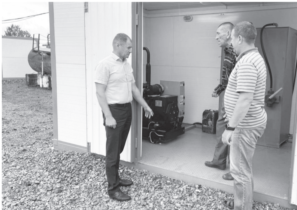
Глава Вяземского района Александр Усенко побывал на дизельной электростанции / фото из телеграм канала администрации
