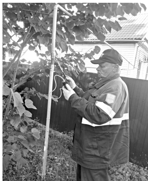
Андрей Кондратьев, слесарь аварийно-восстановительных работ АДС Вяземского района, проверяет муфтовое (резьбовое) соединение на газопроводе
