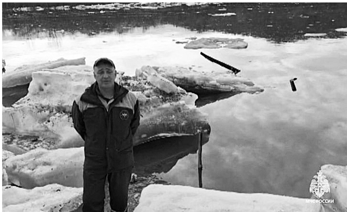
Дамбе на р. Хор в п. Среднехорский из-за промоины во время ледохода требуется ремонт.
