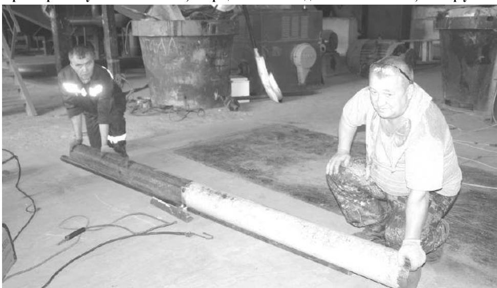
Сергей БУРДИНСКИЙ , электромонтёр электрооборудования котельной, Андрей МАРКОВ , слесарь по ремонту тепловых сетей
