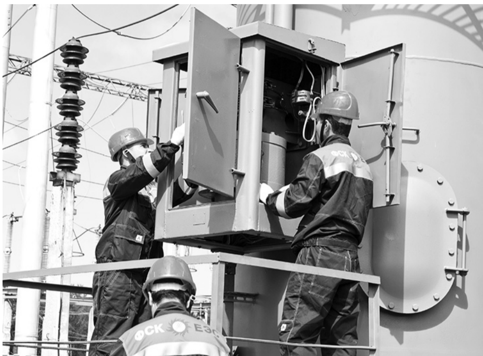
Подстанция «Хехцир» стала камнем в основании объединенной энергосистемы Дальнего Востока.
